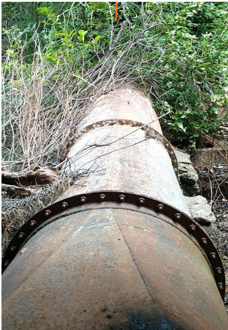
ILUSTRACIÓN 21 TUBERÍA FORZADA DE ALPA CORRAL
