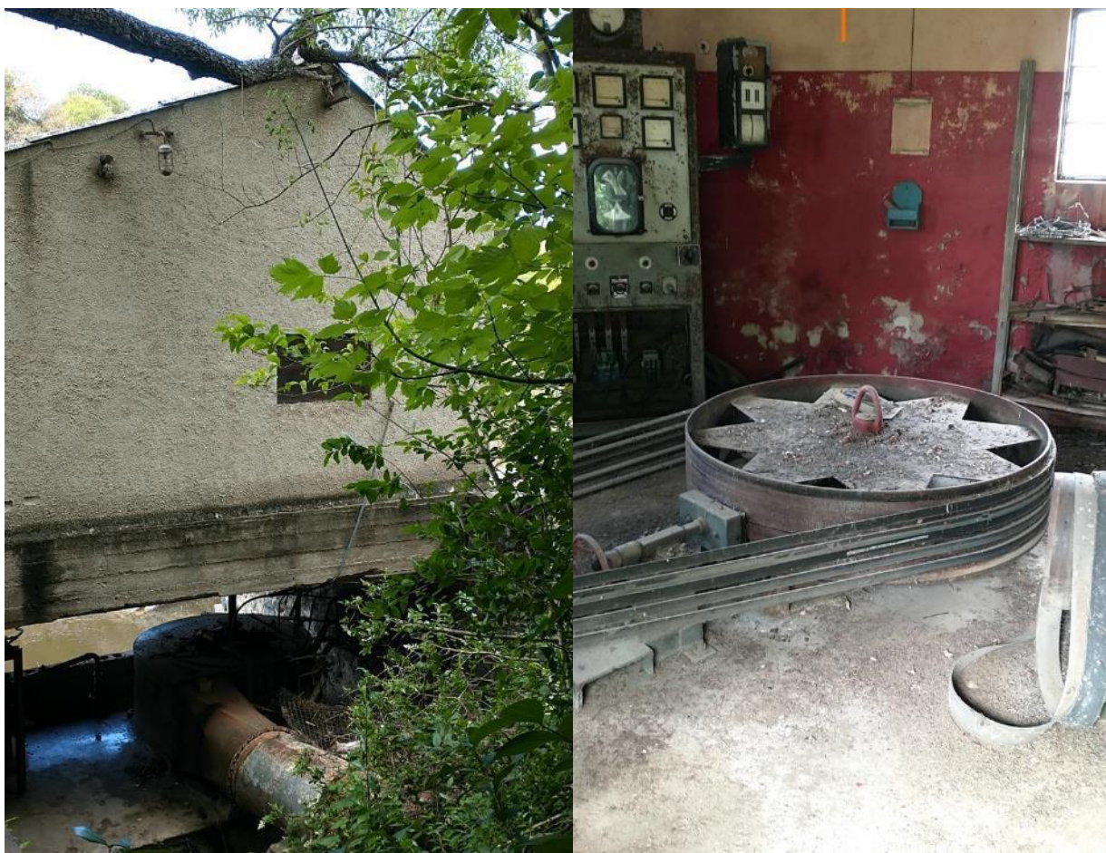
ILUSTRACIÓN 32 TURBINA Y SALA DE MÁQUINAS
