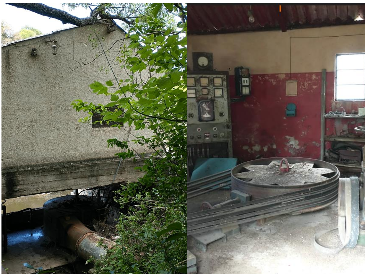
ILUSTRACIÓN 24 CASA DE MÁQUINAS DE ALPA CORRAL
