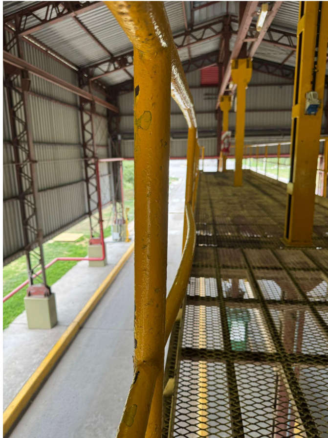
Figura 9 - Pasarela del área de calado deformada por el calador hidráulico
