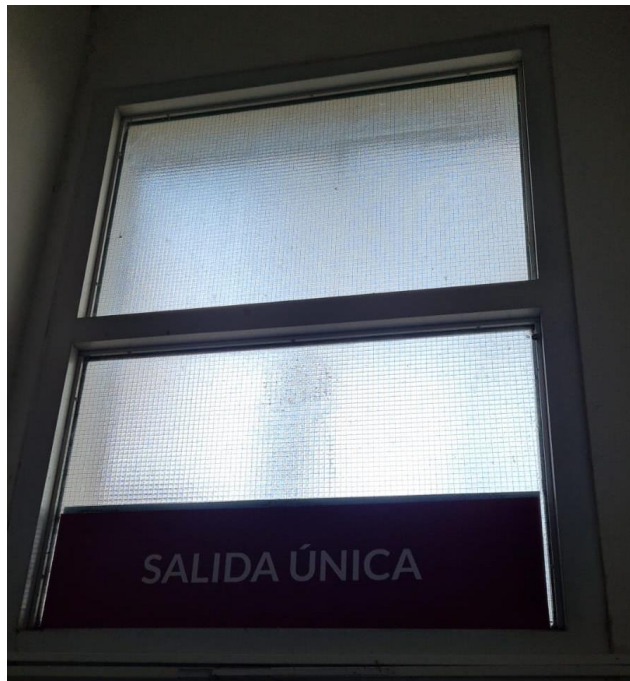
Imagen 30 - Ventana a cambiar en salida de emergencia del Eva Perón. Fuente: Fotografía propia.
