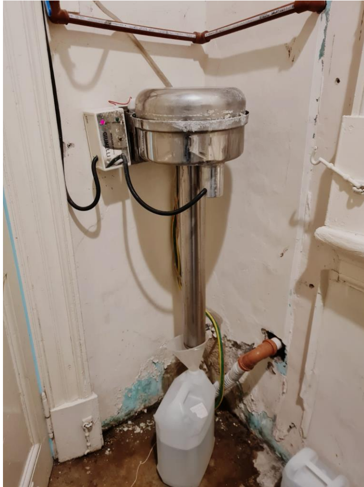
Imagen 33 - Destilador de agua, edificio Eva Perón, UNNOBA. Fuente: Elaboración propia.
