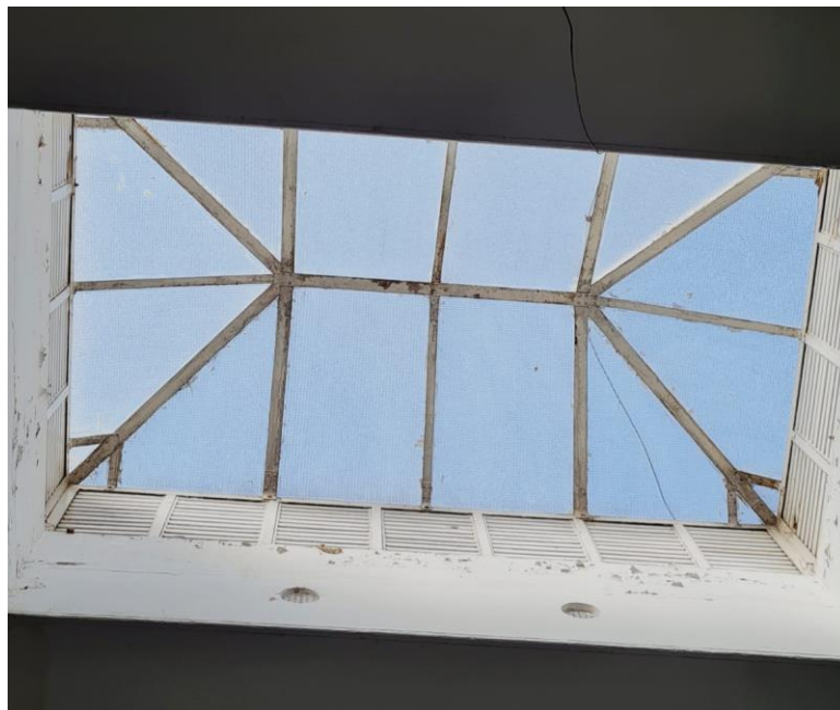
Imagen 32 - Vidrios a cambiar en el techo que se encuentra sobre la escalera principal. Fuente: Fotografía Propia.
