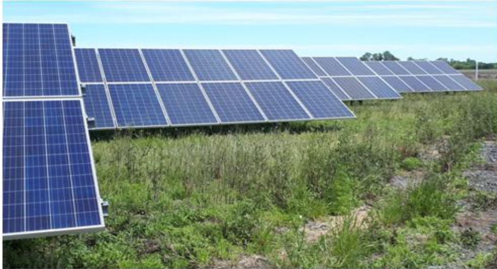
Figura 39. Planta solar El Triunfo, Lincoln. Fuente: propia
