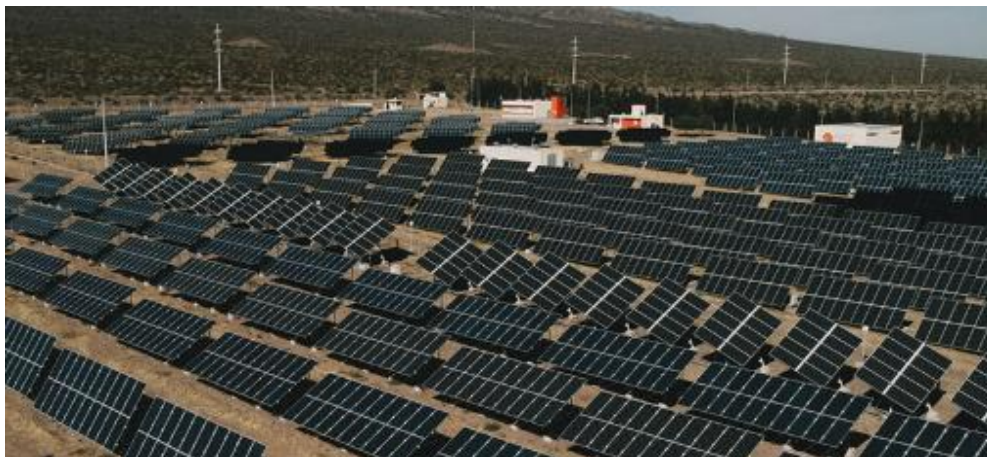
Planta Solar San Juan I. Fuente: EPSE.
