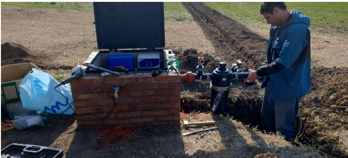
Ilustración 16. Instalación real salida a ramal primario. Fuente: Propia
