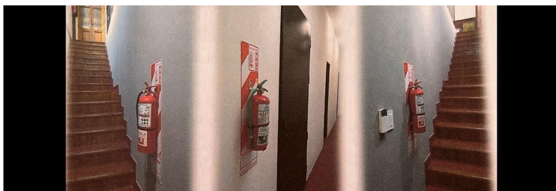
Figura 18. Extintores portátiles para lucha contra el fuego en sector de incendio 1
