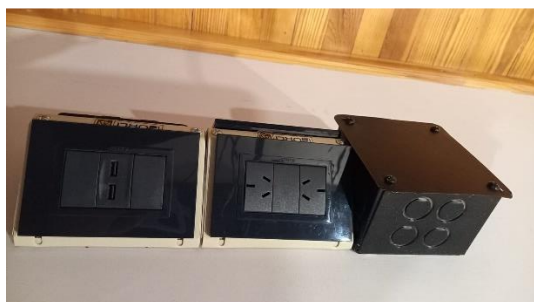
Figura 12. Toma corrientes sector oficinas
