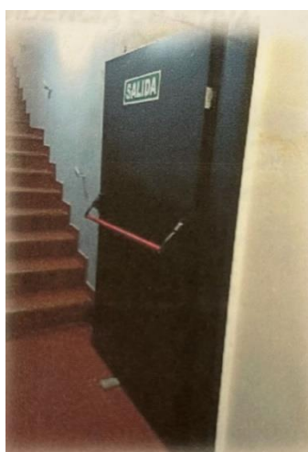
Figura 16. Puerta de emergencia de resistencia al fuego
