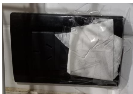
Figura 13. Tomacorrientes sector cocina
