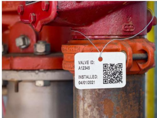
Ilustración 12 - Etiquetado por placas identificatorias. Fuente: Pannier Corporation.
